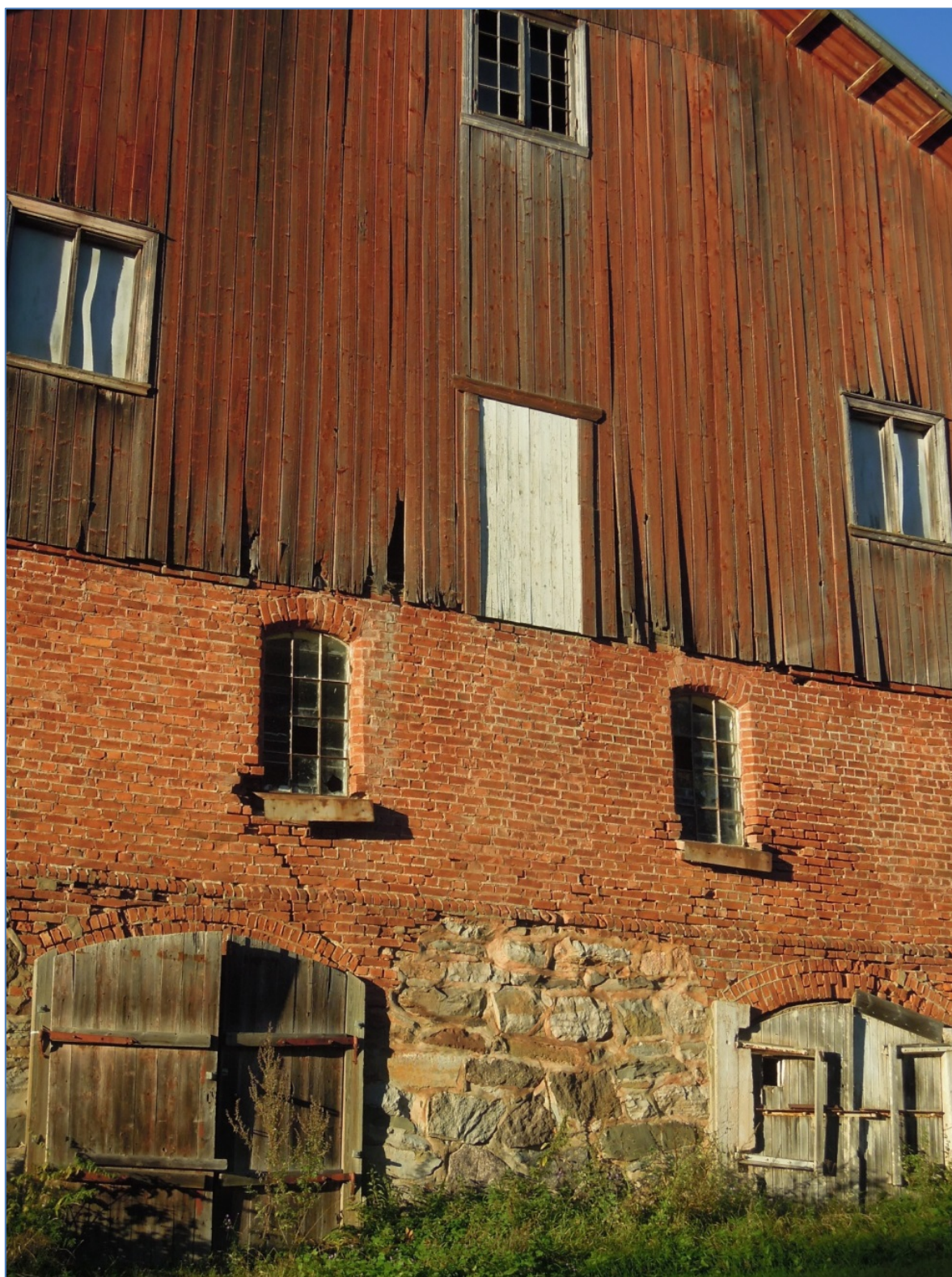
Mange driftsbygninger er forfalne fordi de ikke lenger er i bruk og har en funksjon. Bildet viser den ene vegg på låven på Nedre Sem. Foto: Tor Arne Midtbø
